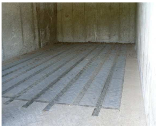
Hangar fermé avec grille de soufflage d'air chaud par le sol Photo : R.Grovel
